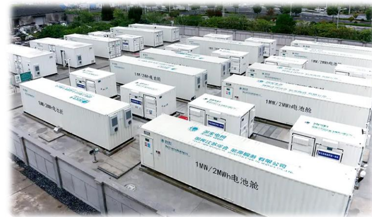
Hệ thống BESS quy mô công nghiệp
